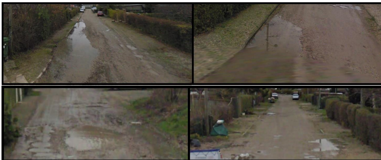
Figur 1 Billederne viser at overfladevandet er stillestående, og altså at belægningen ikke er permeabel – Billedet er taget fra Google idet der ikke under besigtigelserne har ligget overfladevand
